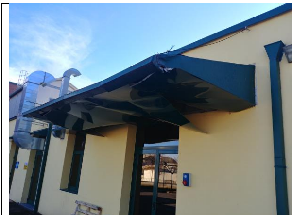
Vista vecchia pensilina danneggiata
