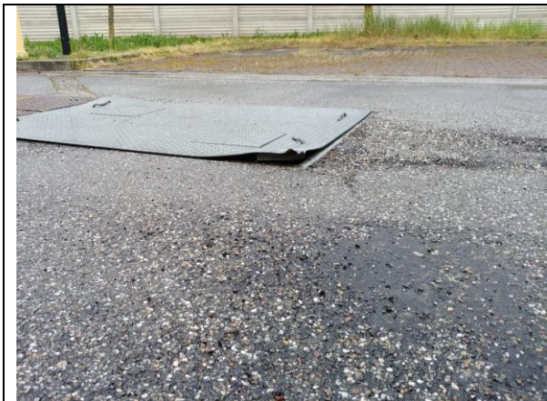
Vista tombino da sostituire
