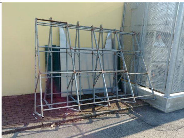
Struttura pensilina da rifare previo calcolo statico
